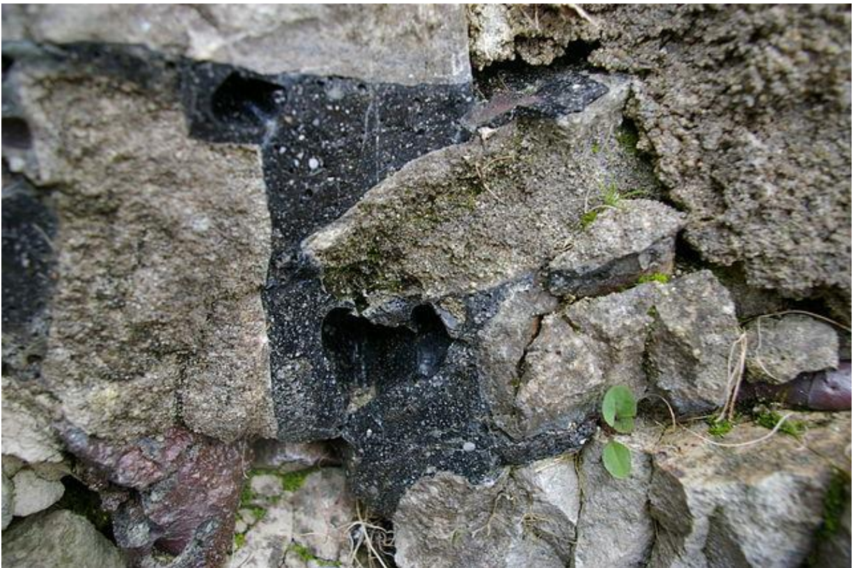
Ilustración 1. Detalle de un muro vitrificado en Sainte-Suzanne, Francia (jp.morteveille, 2007)
